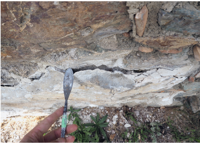
Abb. 9: Putzschicht mehrere Zentimeter vom Mauerwerk abgelöst, Zementkittung an Rändern, Raum AA_36
