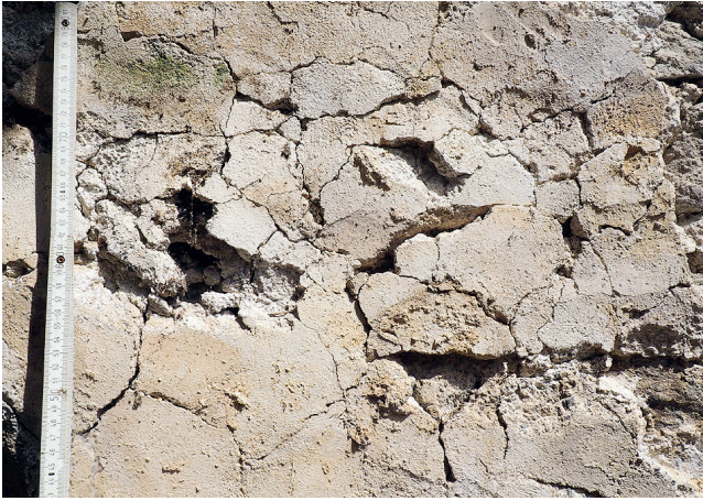
Abb. 8: stark gebrochene und abgelöste Putzstücke in Raum AA_36
